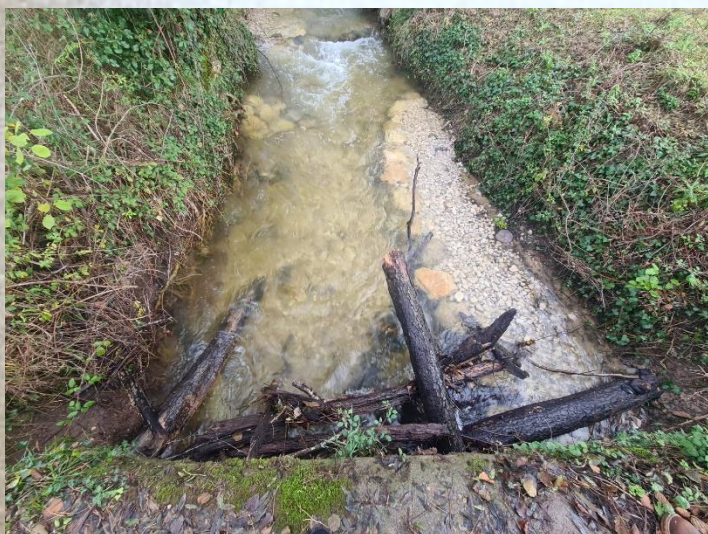
LES ENCOMBRES SUR LES OUVRAGES
